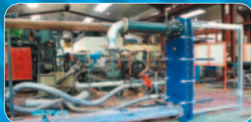
Appareil en test au Centre de Recherche & Innovation CIAT
